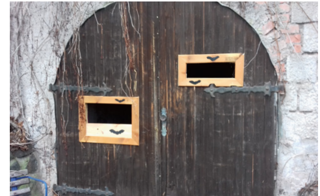
Einflugöffnungen in einer Felsenkellertür. Er kann als Winterquartier von den Fledermäusen genutzt werden. Foto: M. Biedermann
